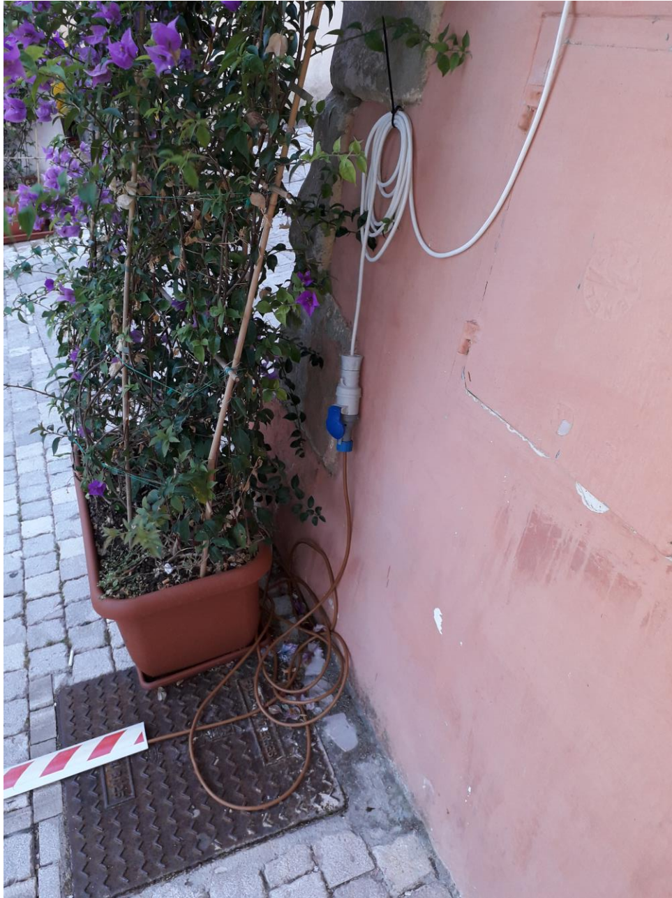
Foto 1 Piazza Vittorio Veneto – raccordo alimentazione pedana con cavo volante diretto a quadro di distribuzione
