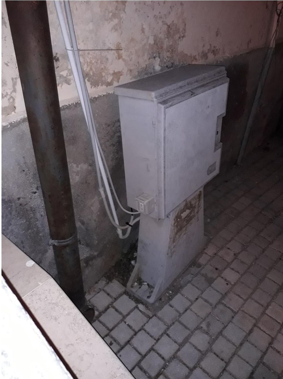
Foto 2 - Piazza Dante-fiano Ufficio postale- entrata cavo volante alimentazione pedana in quadro distribuzione
